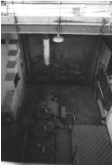
Le bâtiment comprenant la génératrice de secours au diesel : vue intérieure dans une des fosses
