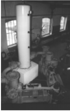
La turbine n°4 Francis, Piccard-Pictet (1919) dans le bâtiment des pompes 1
